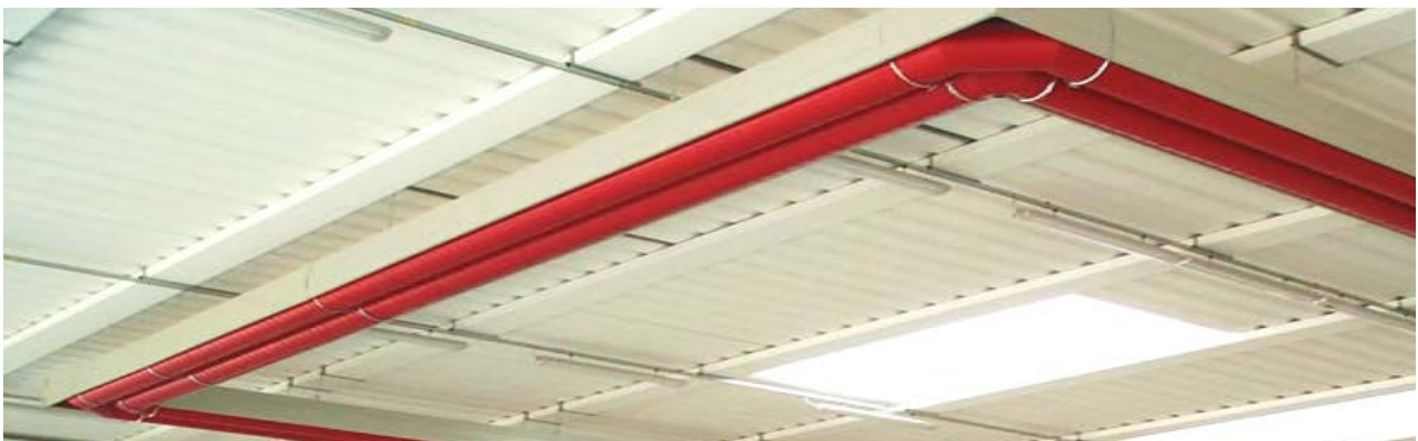
Modules Girad assemblés et installés
