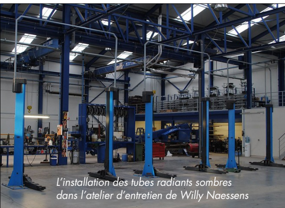
Les conduits intérieurs ont été effectués en cuivre avec un détendeur propane à l'arrivée de chaque brûleur
